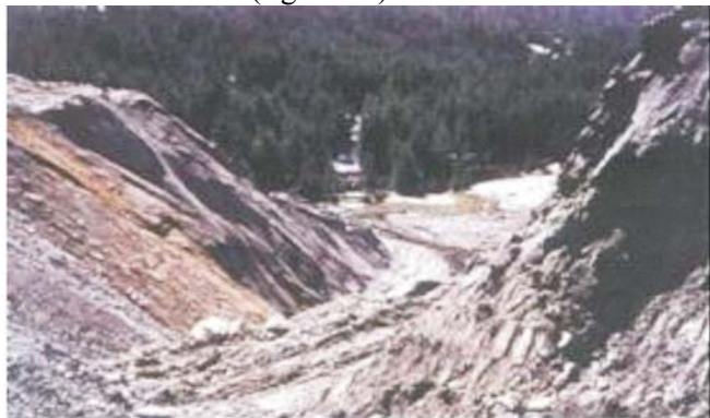
Figura 13 Breșă creată în barajul iazului Novăț la 10 martie 2000 (foto K.E. Lorber)
